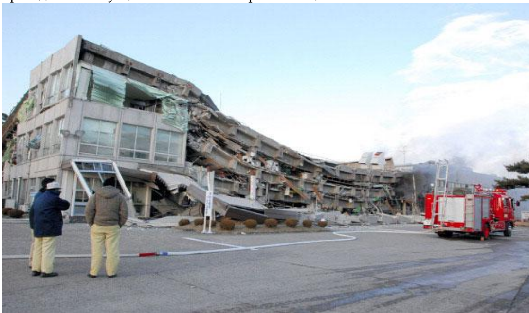
Рисунок 4.1 – Руйнівні наслідки землетрусу
