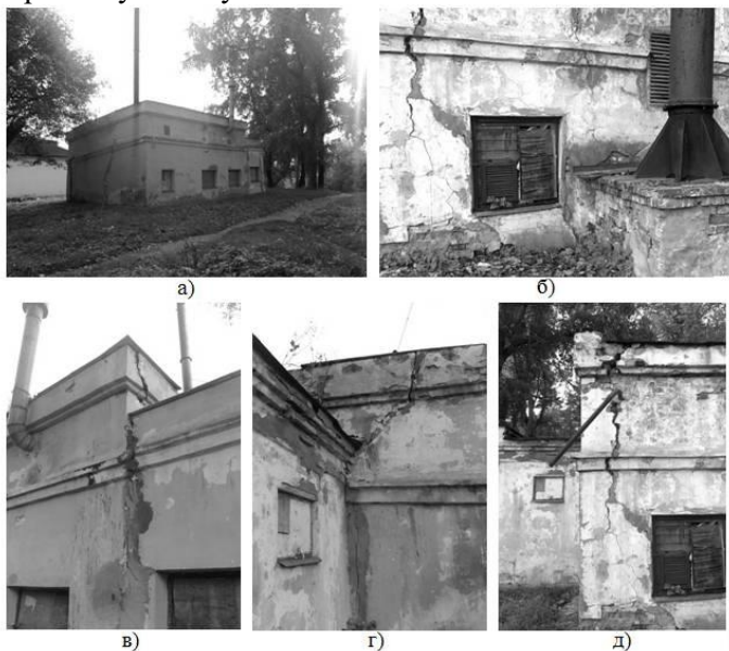
Рис. 2.32. Газова котельня по вул. Горького в м. Чернігів: а) загальний вид; б), в), г), д) деформації споруди
