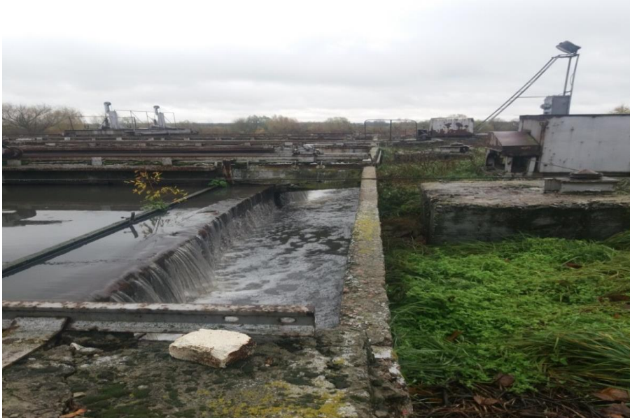
Рисунок 4.48 – Очисні споруди м. Ніжин
