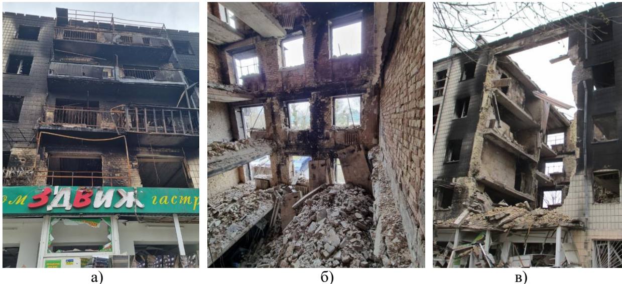
Рис. 1 – Обстежувана будівля: а) під час обстеження (зовні); б) під час обстеження (з середини); в) обвал стіни через 4 дні після проведення обстеження.
