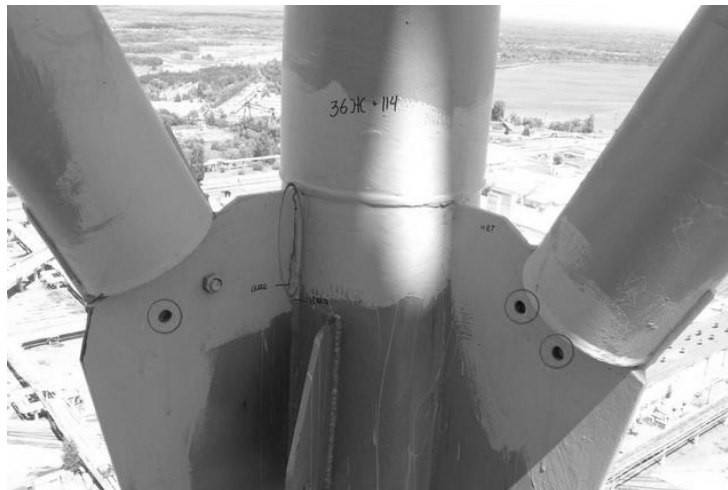
Рис. 3. Відсутність болтових з'єднань нової вентиляційної труби (НВТ-2) Чорнобильської АЕС [3].
