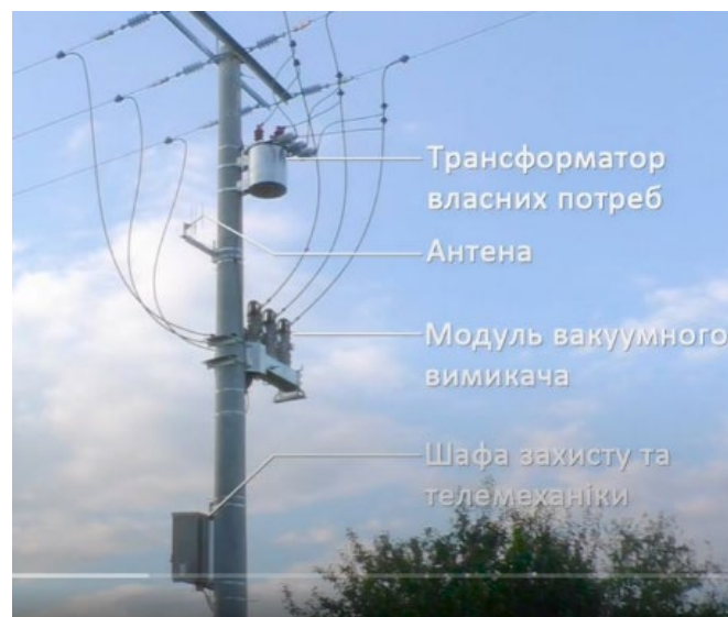
Рис. 1 – Автоматичний реклоузер, встановлений на опорі повітряної лінії
