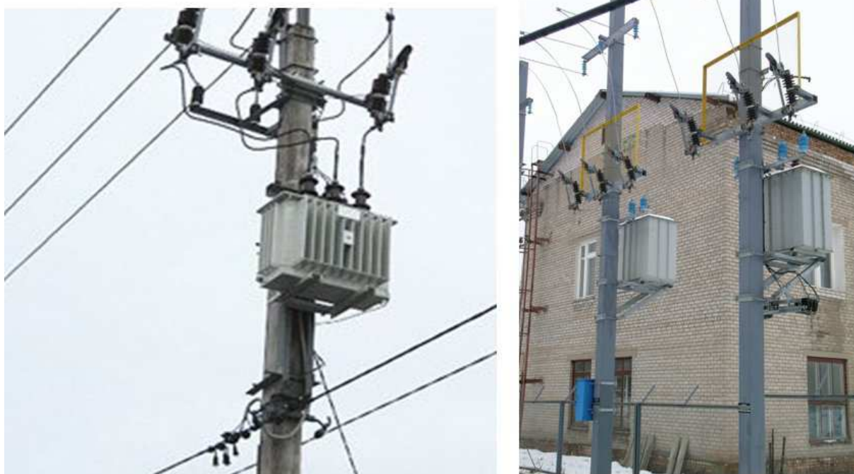
Рис. 2. ПРВТ-10 на существующих объектах электрических сетей
