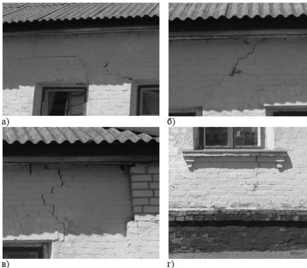
Рис. 12.45 – Деформації фасаду, що виходить на вул. Князя Чорного
