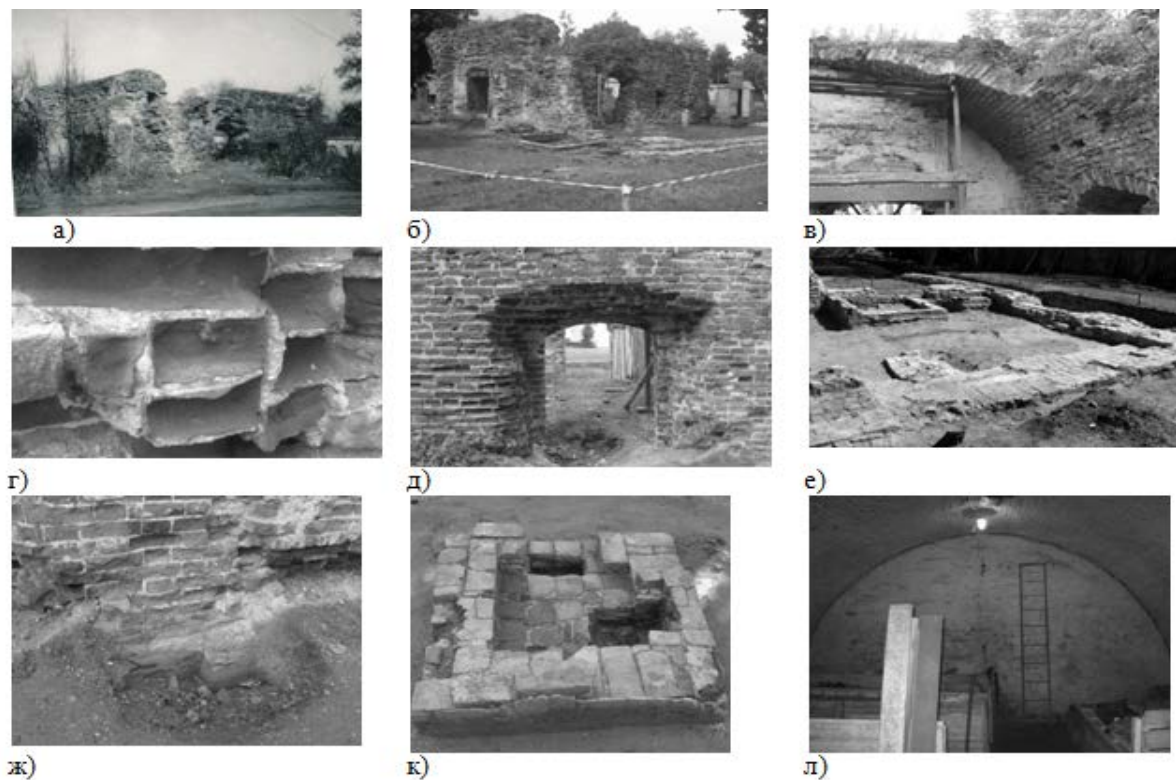
7.37 – Залишки будинку Ігумена: а) – фото 1992 р.; б) – сучасний вид; в) – залишки перекриття; г) – вивітрювання кладки стін; д) – руйнування перемичок отворів; е) – вид фундаментів під час розкопок 2012 р.; ж) – шурф для огляду цоколю; к) – фундамент опалювального пристрою; л) – загальний вид підвальної частини
