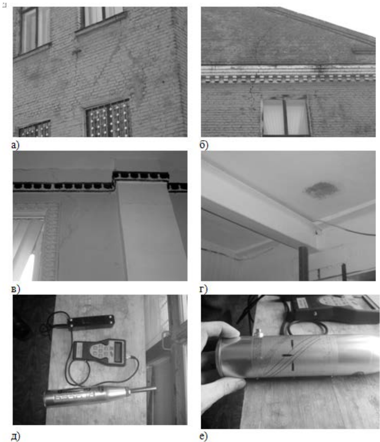
Рис. 12.53 – Обстеження будинку по вул. Стрілецькій: а), б) – виявлені тріщини зовнішніх стін; в) – тріщина, вид з приміщення; г) – підготовлена ділянка для визначення марки бетону перекриття; д), е) – прилади за якими визначались характеристики матеріалу та армування плит перекриття
