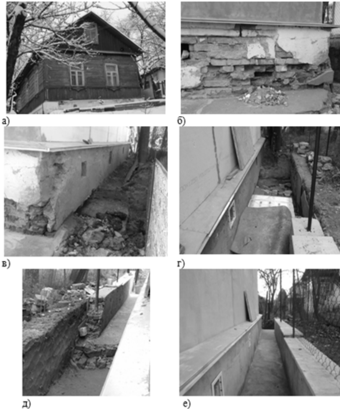
Рис. 12.50 – Підсилення фундаменту одноповерхового будинку по вул. 1-го Травня в м. Чернігові: а) – загальний вид будинку; б) – вид фундаменту до підсилення; в) – підсилення фундаменту; г) – влаштування монолітної плити; д) – влаштування підпірної стіни; е) – загальний вид після завершення робіт
