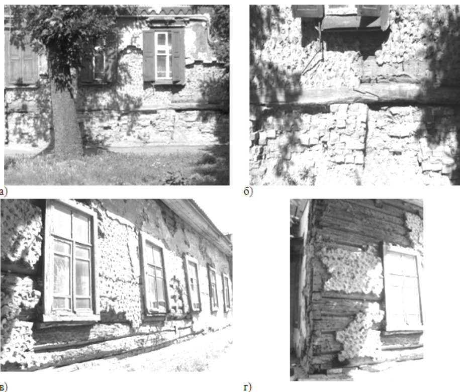
Рис. 8.3 – Одноповерхові будинки в м. Прилуки: а) – цокольна частина будинку знаходиться в незадовільному стані; б) – частина облицювання зруйнована; в) – відсутнє облицювання на фасаді будинку по вул. Київській; г) – кут будинку, оголення дерев'яного каркасу
