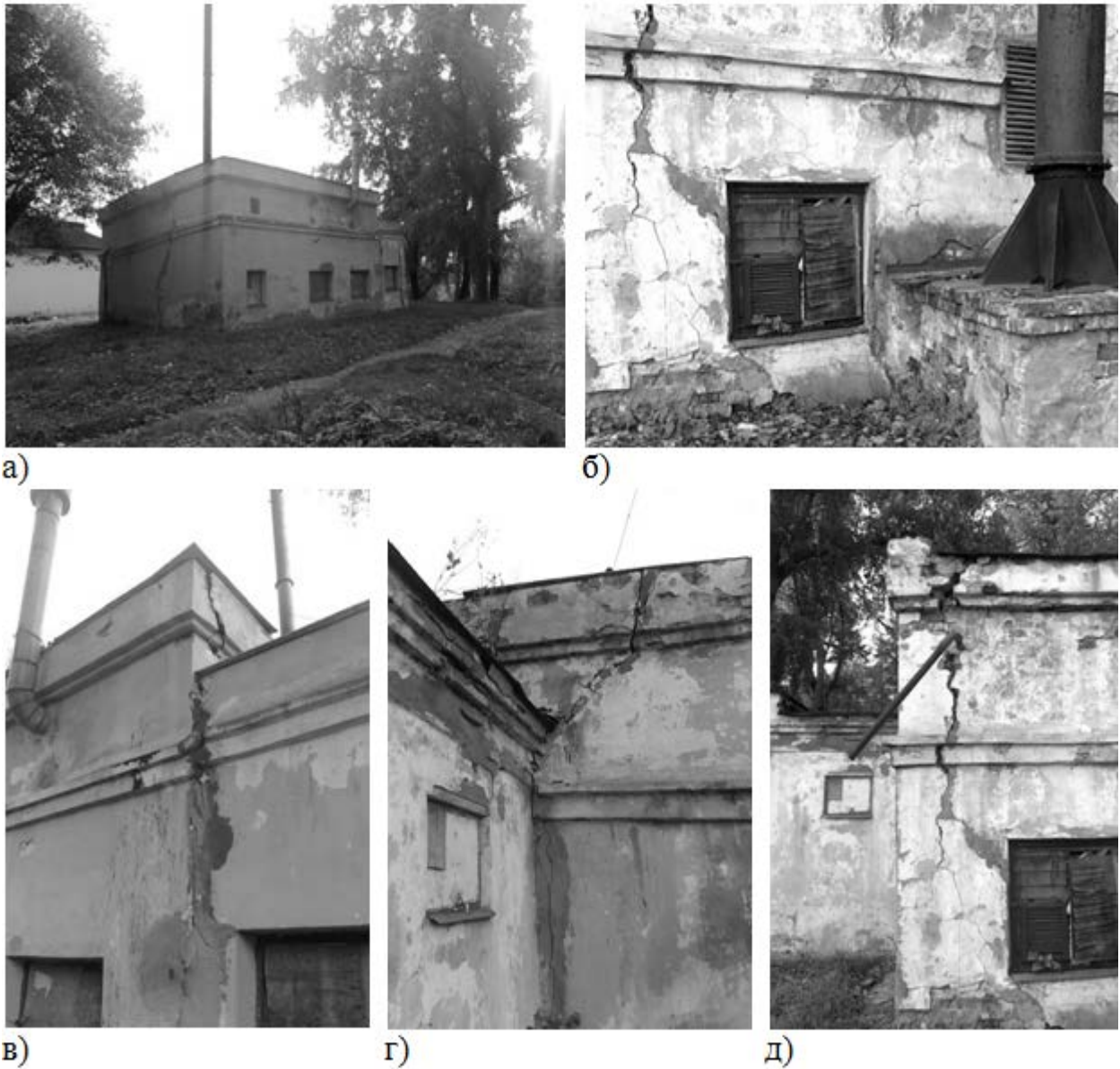
Рис. 12.33 – Газова котельня по вул. Горького: а) – загальний вид; б), в), г), д) – деформації споруди
