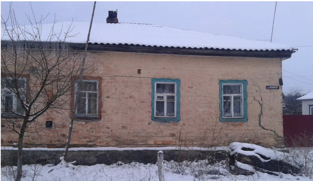
Рис. 2.2 – Утворення тріщин внаслідок просідання фундаменту
