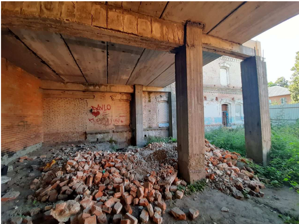
Рис. 2.5 – Деформації залізобетонних елементів
