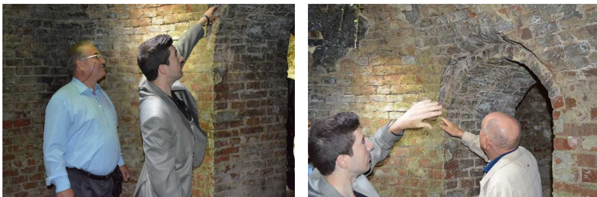
Рис. 1.1 – Виявлення дефектів під час технічного обстеження
