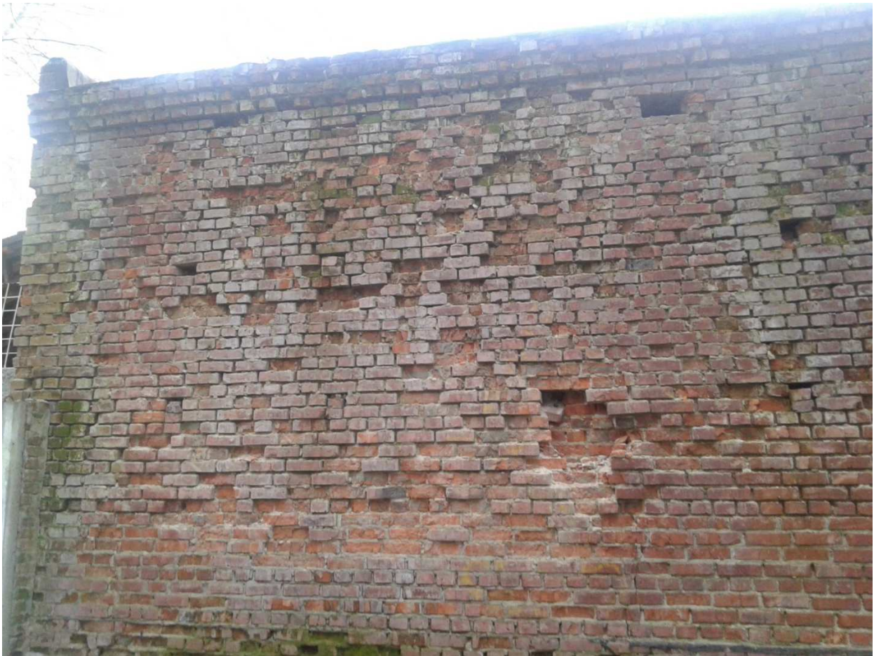
Рис. 2.4 – Деструкція стіни: вивітрювання, утворення висолів, пліснява та мох на поверхні
