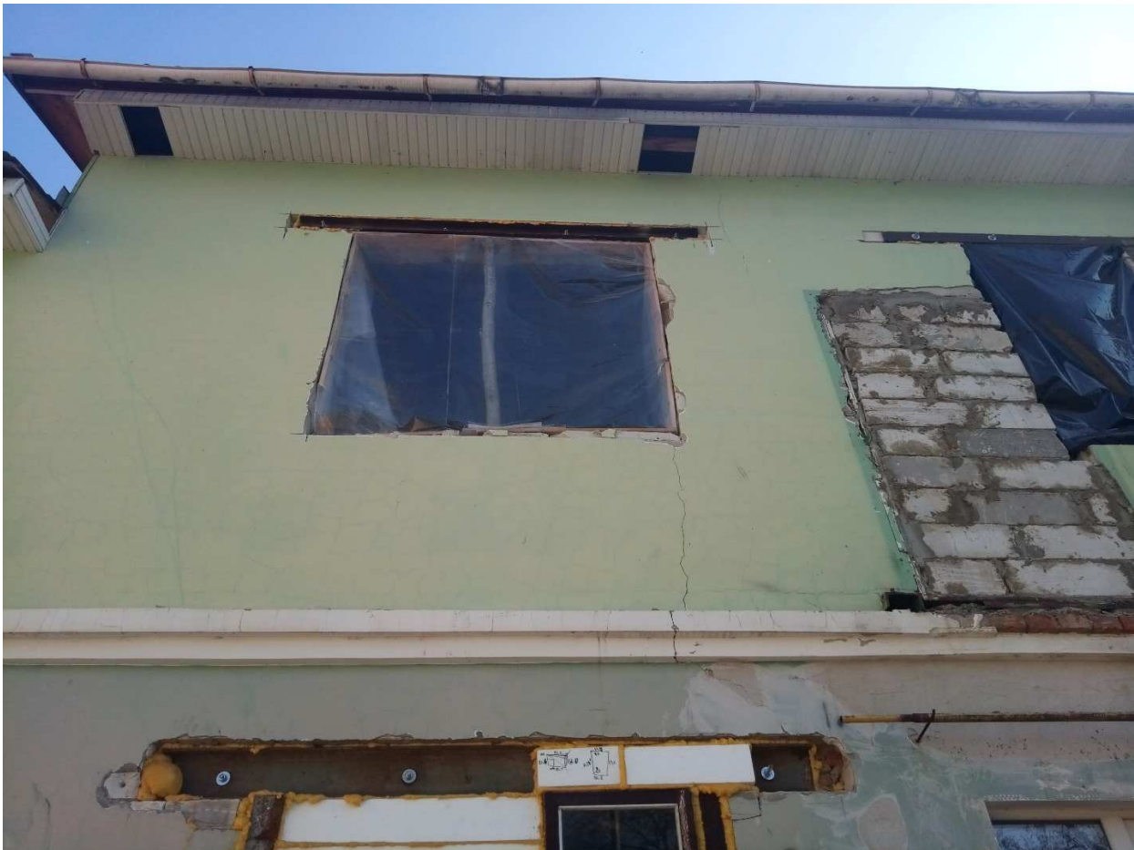
Рис. 2.1 – Утворення тріщин унаслідок проведення некоректних робіт з пробивання та закладення отворів
