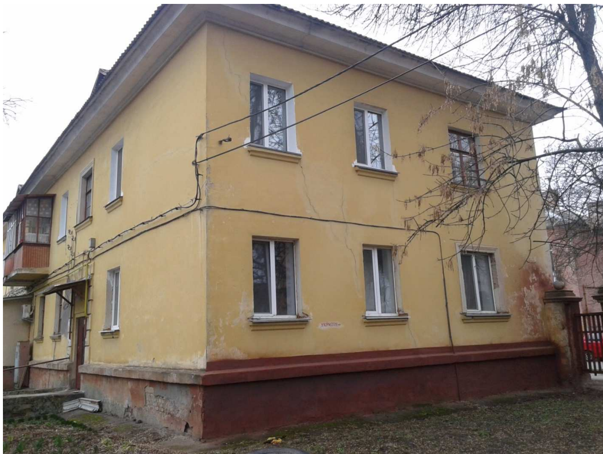
Рис. 2.6 – Тріщина, що йде від покрівлі до фундаменту
